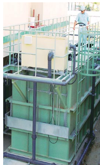
向迪拜市内的劳工营地引进的MBR设备。该设备大约可以处理1,500人的生活废水。
