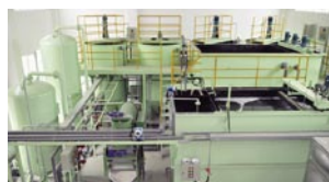
废气处理设施
