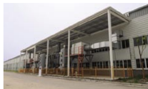
废气处理设施
